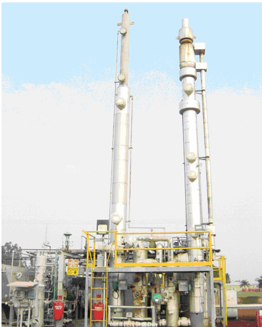
Figura 3.1: Foto ilustrativa da Unidade de Gás de Malongo. À esquerda, torre estabilizadora e, à direita, torre deetanizadora.
